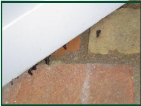
Point d'entrée et déjections de chauves-souris.
