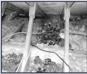
Isolant contaminé par les rats laveurs.
