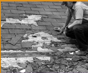
Toiture endommagée par une mère raton laveur.
